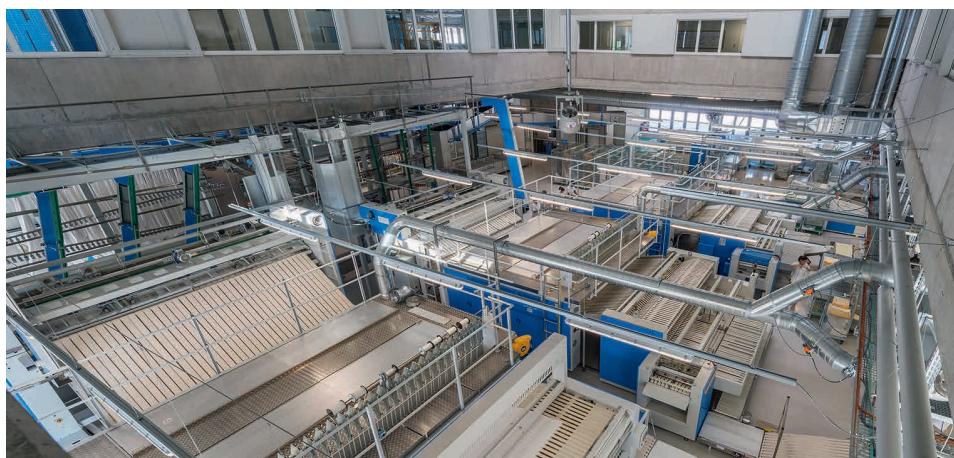
Die Abwärme der drei Wäschemangeln wird zur Wiederverwertung in einem 30 Kubikmeter grossen Wärmespeicher zurückgehalten.
